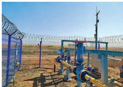
Рис. 2. Общий вид газовой скважины, оснащенной системой «Скважина-ТР» с функциями контроля технологических параметров и загазованности по сероводороду
