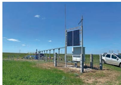
Рис. 4. Энергонезависимая система телемеханики кустов газовых скважин «СТН-3000-Р» с применением солнечных батарей
